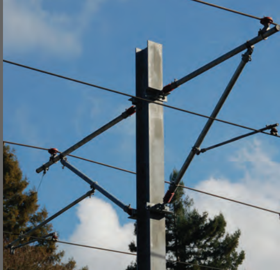
POSTE INDUSTRIAL OCS - ZONAS GENERALES FUENTE DE LA IMAGEN: ZGF
